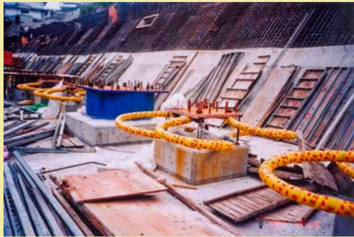
鋼環阻尼器一座重量達六百公斤，是不規則建築中控制震度的重要隔震系統。攝影／劉鼎龍
