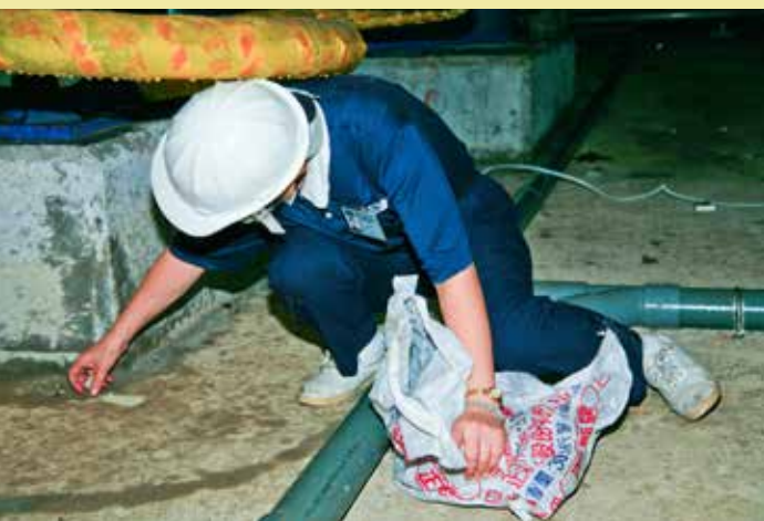
隔震系統在地下夾層中、空間窄小容易藏污納垢，保養不易，圖為臺北地區的慈濟志工協助清掃隔震層，一一撿拾垃圾。攝影／陳倪旺
