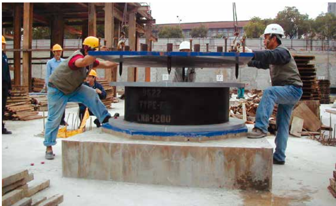
合心樓可承受芮氏規模八級的地震，地震發生時，整棟建築物會產生一百二十公分位移，移去地震威力。圖中為隔震墊，由鋼板與橡膠一層層堆積，將建築結構體與地殼分離。
