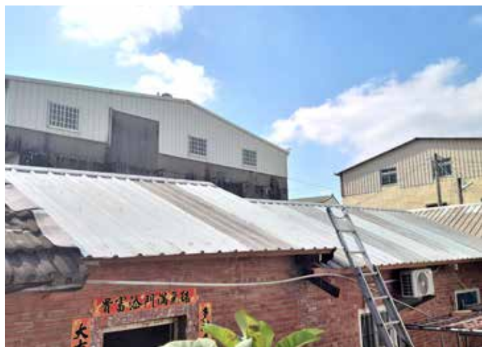
修繕後的屋頂在自然使用狀況下，預計可使用五十年以上。
